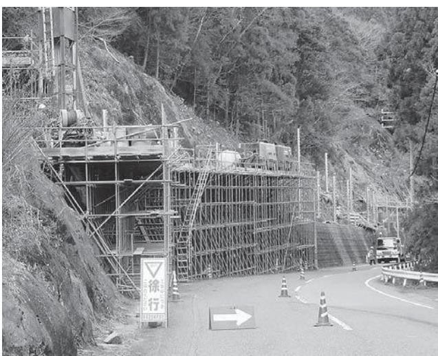
落石防止で安全を確保する（傍示橋上）
