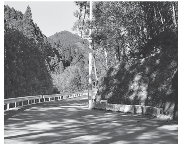
切り取り出来ていない山側
