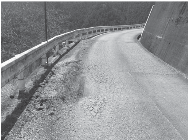
林道生実八重地線の傷んだ路面
