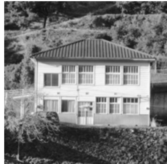
雨漏りしている旧役場
