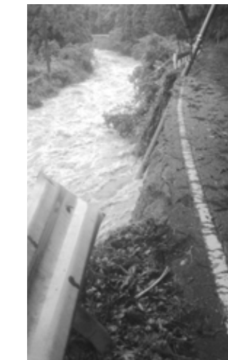
台風で削られた県道
