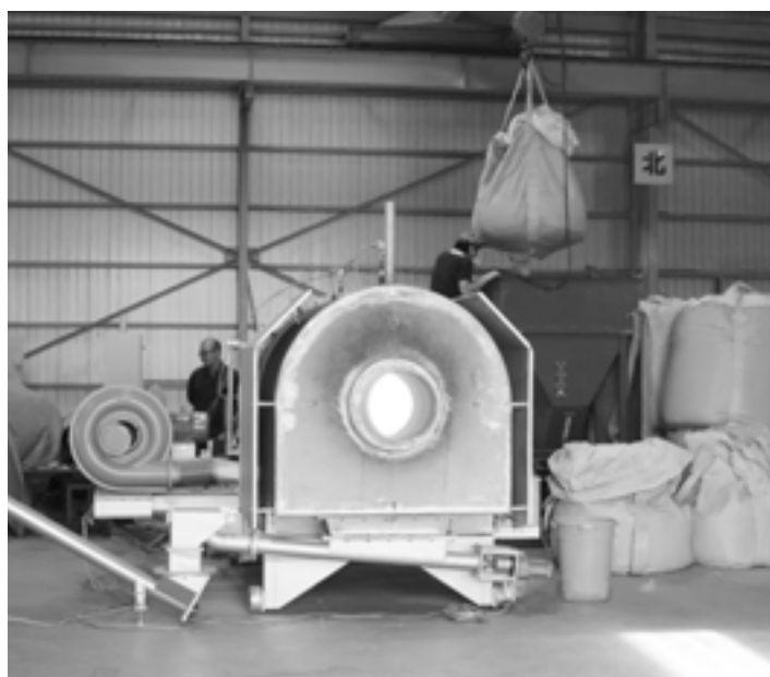
オガ粉ボイラー
