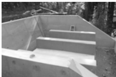
完成がまたれる水道施設（府殿）
