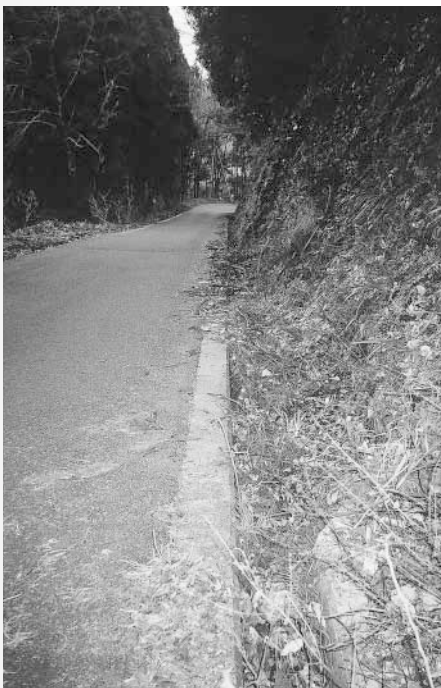
町道元山槻地線の排水路
