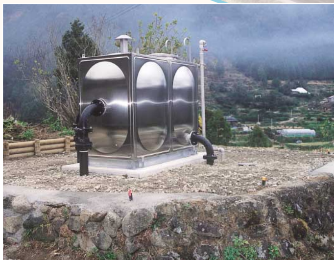
いっきゅう地区給水タンク（影地区）
